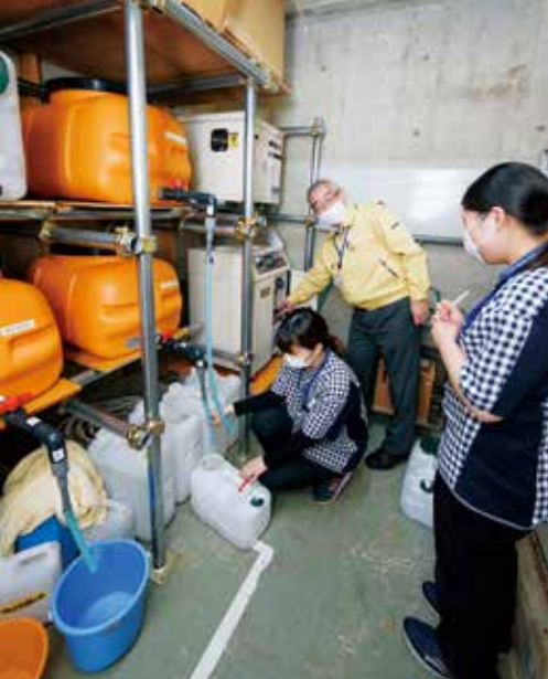
小松営業所内に設置された次亜塩素酸水生成機
